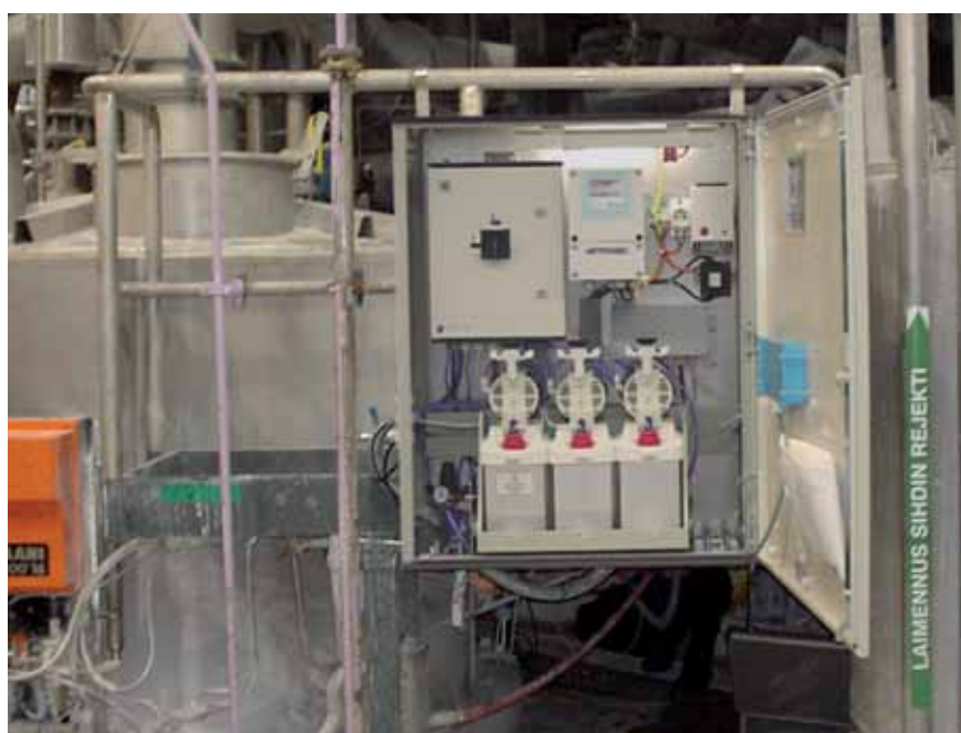
Automatyka pomiaru pH zawiesziny gipsowej na IOŚ dzięki systemowi TopCal CPC310
