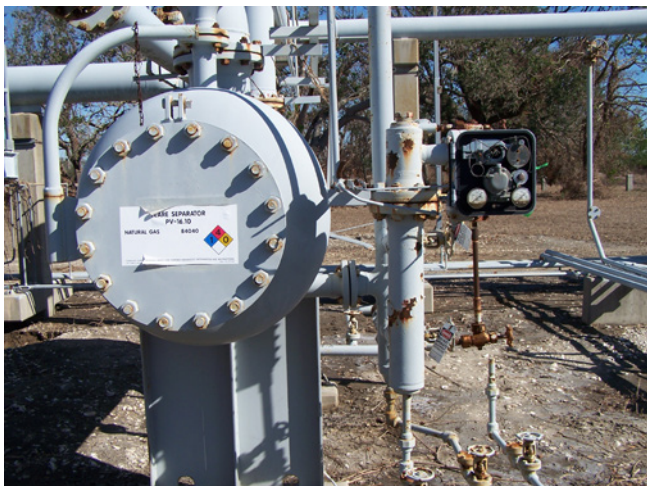
Uszkodzony, nurnikowy pomiar poziomu w separatorze woda/węglowodory
