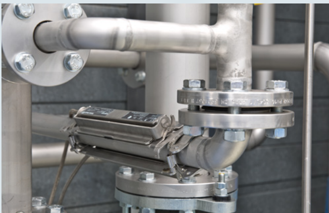
Pomiary zastępcze - zamiast uszkodzonych przepływomierzy
