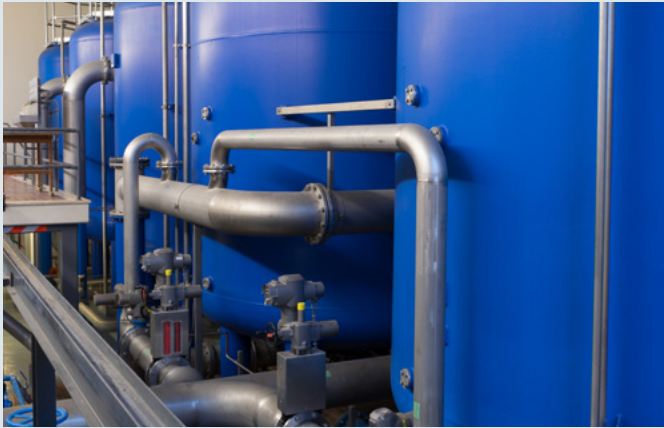
Woda chłodząca i technologiczna (media użytkowe)
